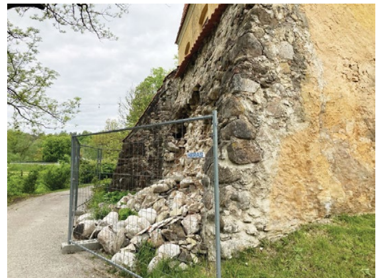
Attēlā: Lai atjaunotu nobrukušo akmens mūra atbalsta sienu, paredzēts veikt mūra virsmas attīrīšanu.
